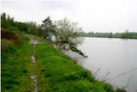
Fig. 30 : Berge à hauteur de la rue de la maison blanche.
