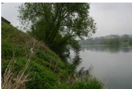
Fig. 27 : Pente abrupte de la berge.
