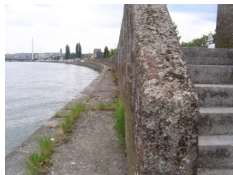
Figure 159 : Sécurité des biens et des personnes insuffisante dans la rue Rivage-en-Pot
