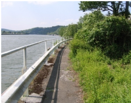
Figure 53 : Zone non accessible et non praticable le long de la N617b
