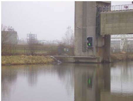
Figure 9 : porte pont garde entravant la pratique de la pêche en amont de la darse de Feluy
