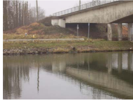
Figure 12 : berge praticable sauf sur un tronçon de 23 m
