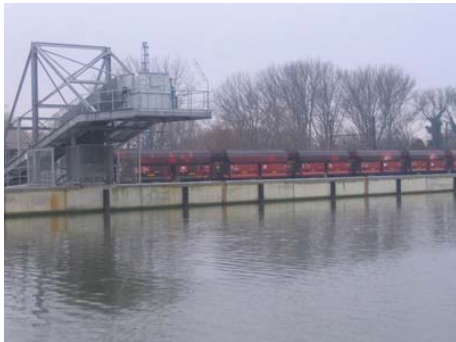
Figure 24 : Berge impraticable en raison de la hauteur du surplomb en aval du pont route de Clabecq
