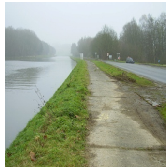
Figure 2 : zone praticable au niveau de la confluence entre la branche de Bellecourt et le canal Charleroi-Bruxelles
