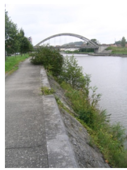
Figure 13 : Zone impraticable en amont du pont d'Antoing
