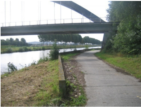
Figure 28 : Pont Pecq-Harinnes. Zone inaccessible et impraticable
