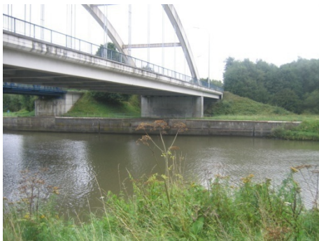
Figure 38 : Pont route Antoing-Bruyelle. Zone inaccessible et impraticable
