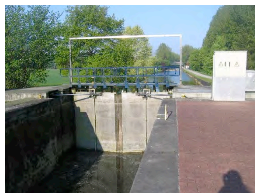
Figure 185 : berge inaccessible et impraticable à l'Ecluse n°5
