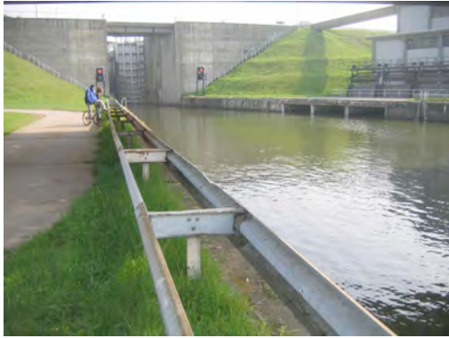
Figure 150 : berge impraticable en aval de l'écluse de Pommeroeul
