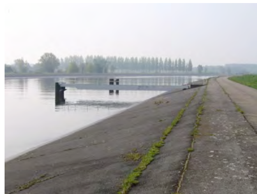
Figure 154 : berge impraticable en aval du pont route de Pommeroetul
