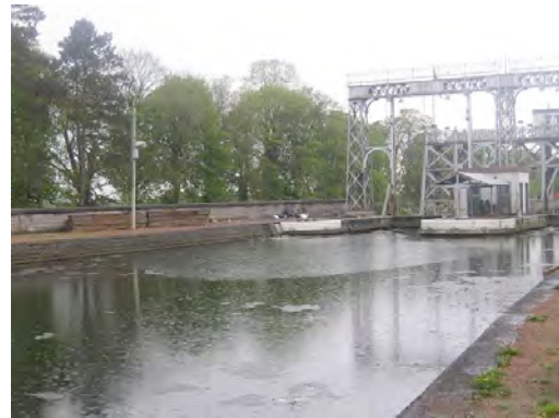
Figure 56 : berge inaccessible et impraticable à l'Ascenseur n°2
