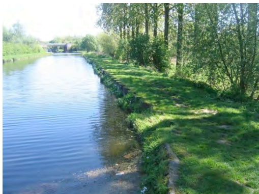
Figure 182 : berge inadaptée à la circulation et au stationnement des véhicules à l'Ecluse n°2
