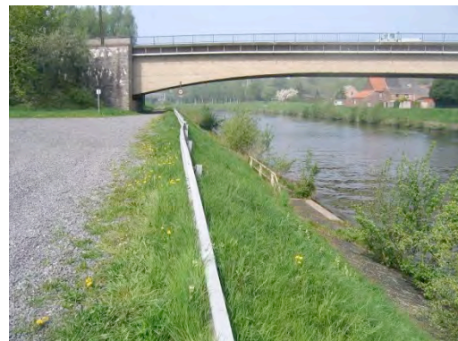
Figure 89 : berge impraticable en amont du pont rue de Tertre
