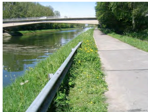
Figure 125 : berge impraticable au pont du Boustiau
