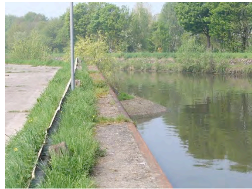
Figure 85 : berge impraticable en amont du pont rue de l'Enfer
