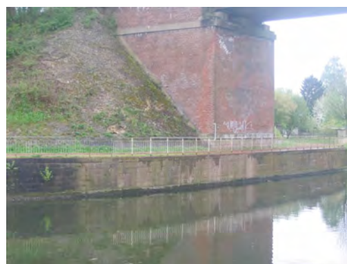
Figure 52 : berge impraticable au pont S.N.C.B.
