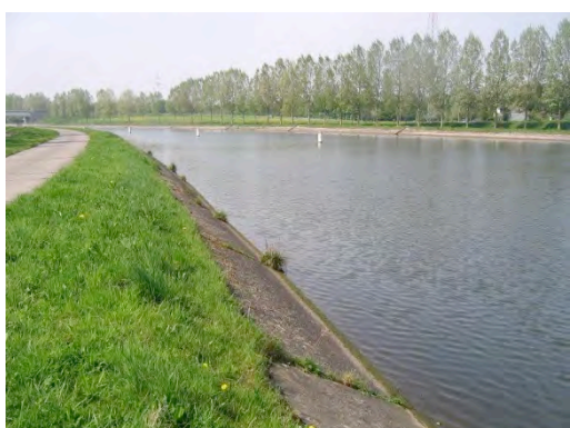
Figure 12 : surplomb de la berge supérieur à 2 m en aval de l'écluse d'Havré
