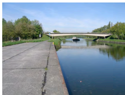
Figure 101 : berge impraticable au quai public de Wiers
