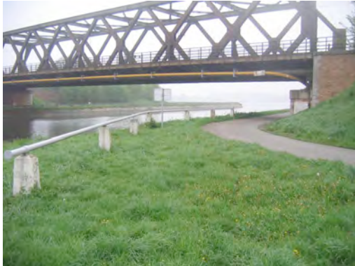
Figure 106 : berge impraticable en amont du pont S.N.C.B.
