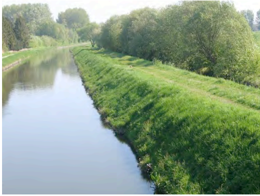
Figure 190 : berge impraticable en aval de l'Ecluse n°14
