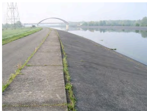
Figure 138 : berge impraticable au niveau de la rue d'Harchies
