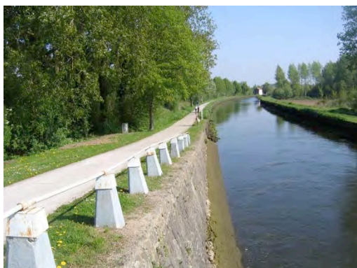
Figure 170 : berge impraticable à l'Ecluse n°11
