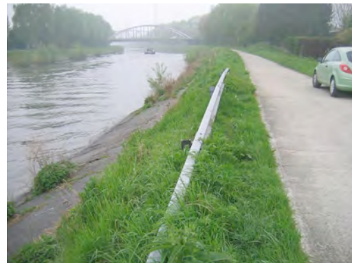
Figure 113 : berge impraticable en amont du pont rue Louis Cathy
