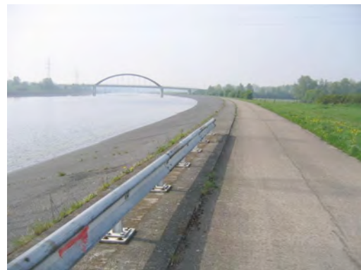
Figure 152 : berge impraticable au niveau de la rue d'Harchies
