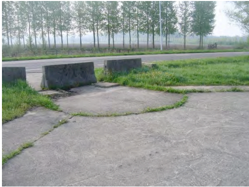
Figure 141 : accès bloqué entre le chemin du halage et la chaussée Brunehault
