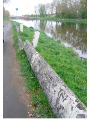
Figure 4 : berge impraticable sur 30 m en aval du pont Morlet
