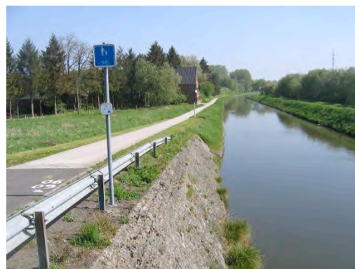
Figure 171 : berge impraticable en aval de l'Ecluse n°14
